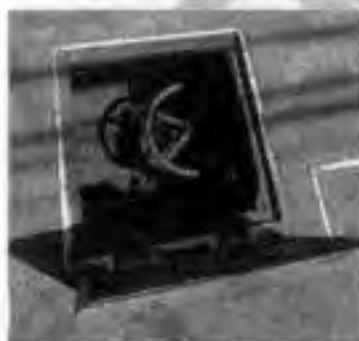
Ilustración 1 Válvula de la calle Guadalupe Victoria esquina con Quintana Roo.
