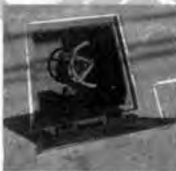
Ilustración 6 Válvula de la calle Guadalupe Victoria esquina con Quintana Roo.
